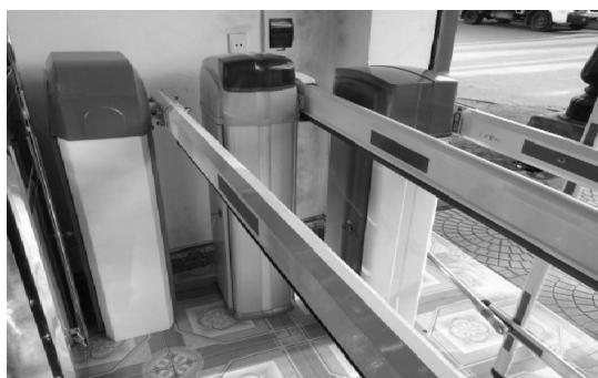
Barrier tự động
